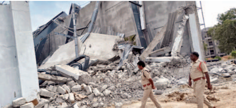
కుప్పకూలిన నిర్మాణంలో ఉన్న ఆడిటోరియం భవనం
